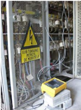
Aparatul Fluke 1735 montat în interiorul stației de transformare
